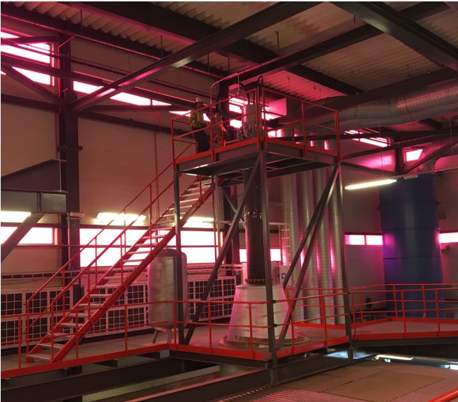
Biofuel Boiler - Växjö, Sweden
